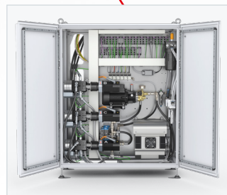
Der Dosiermaschinenschrank beinhaltet die Komponenten der Dosierperipherie wie z. B. die Dosierpumpen.
